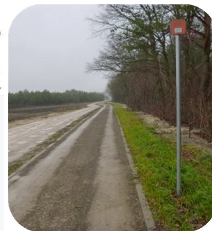
Fot. 12. Dewastacja trasy przez samochody, autor. P. Książek
