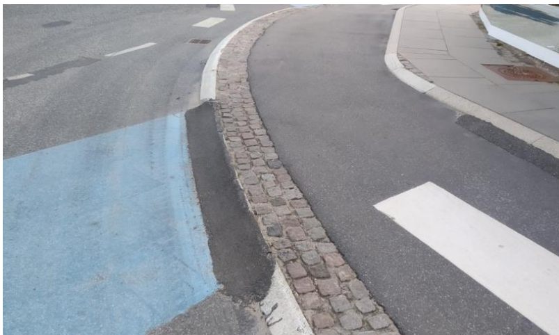
Fotografia 14. Zniwelowanie różnicy wysokości krawężnika do osi drogi poprzez małą wylewkę asfaltową (Billund, Dania).
