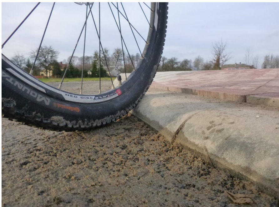
Fotografia 13. Przykład ograniczenia dostępności drogi rowerowej, ciągu pieszo-rowerowego. Źródło: Materiały Urzędu Marszałkowskiego Woj. Pomorskiego
