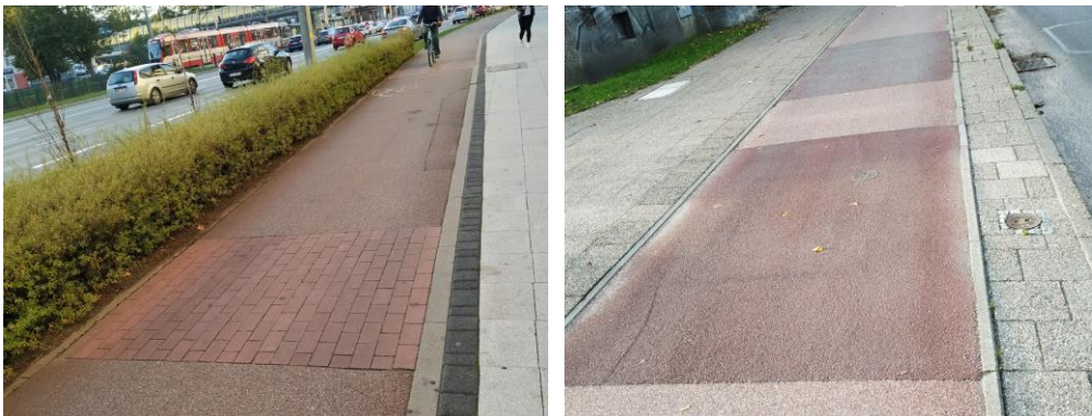
Fotografia 34-35. Przykład wprowadzenia etapowego wypełnienia ubytku powstałego w wyniku prac ziemnych, w tym przez gestora sieci.
