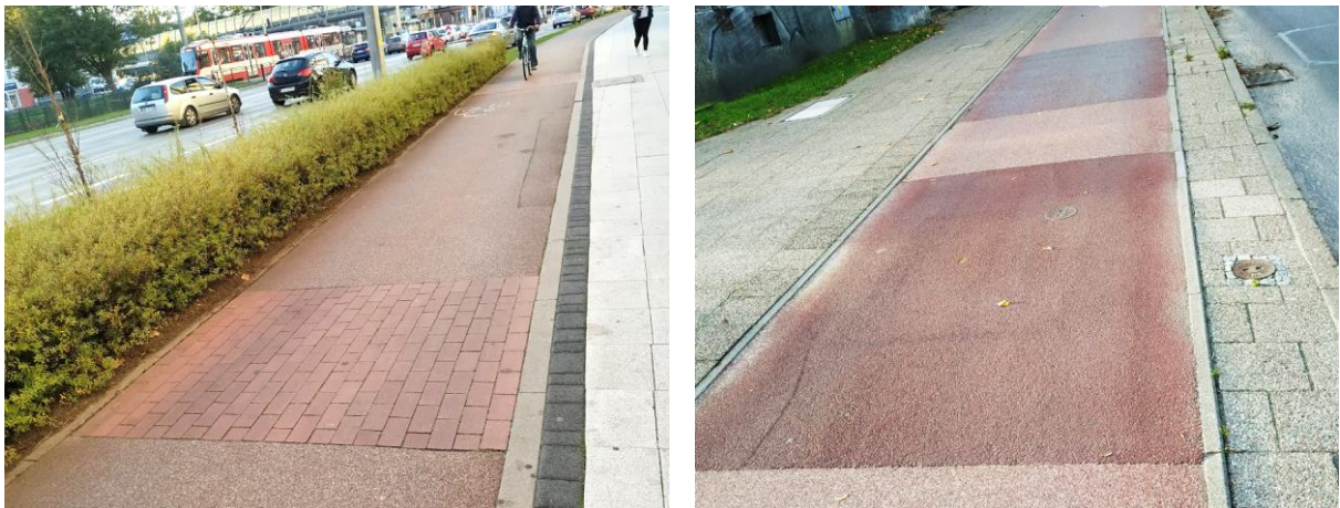
Fotografia 34-35. Przykład wprowadzenia etapowego wypełnienia ubytku powstałego w wyniku prac ziemnych, w tym przez gestora sieci. Etap 1: Warstwa ścierna – kostka fazowana Etap 2: Warstwa ścierna – masa bitumiczna Źródło: Materiały Urzędu Marszałkowskiego Woj. Pomorskiego.
