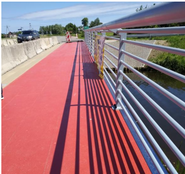
Fotografia 17. Odgicenie balustrada na obiekcie inżynierskim, trasa R9, gmina Cedry Wielkie. Źródło: Materiały Urzędu Marszałkowskiego Woj. Pomorskiego.
