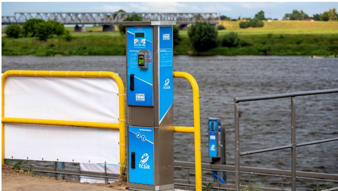
Fot.38. Przykład rozdzielnic elektrycznej i wody przeznaczonych do zasilania jednostek pływających z wbudowanym źródłem światła , źródło:
