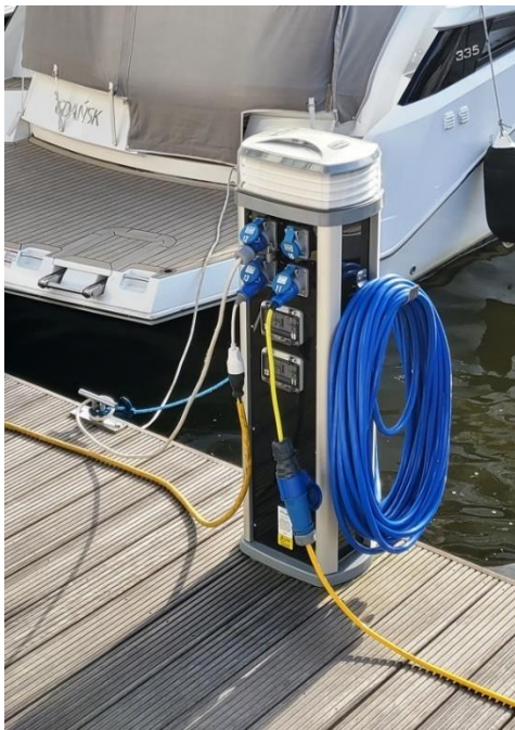
Fot. 39. Postument z instalacją zaopatrzenia w energię elektryczną, modułem oświetleniowym i wodą wraz z zwieszonymi węzami; źródło: archiwum własne
