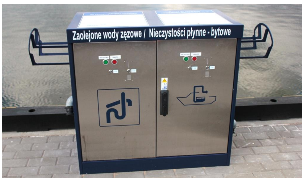
Fot.44. Pompa do odbioru zaolejonych wód zęzowych i nieczystości bytowych; źródło: archiwum własne
