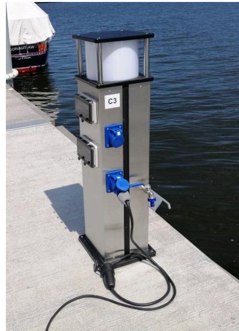
Fot. 40. Postument z instalacją zaopatrzenia w energię elektryczną, modułem oświetleniowym i wodą; źródło: archiwum własne
