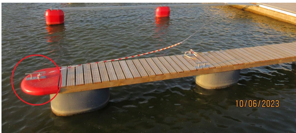
Fot.30. Nieprawidłowe ” zakończenia Y-bomów; Fot. A. Różycki
