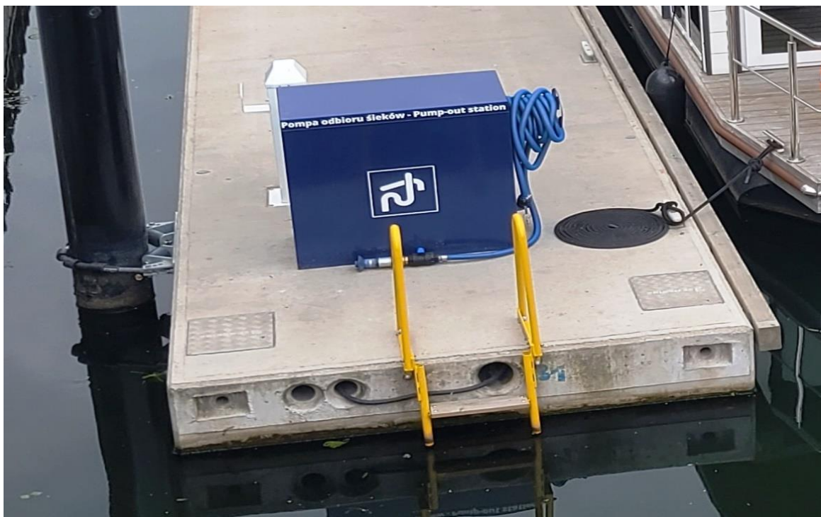
Fot.43. Stacjonarna pompa do odbiorów ścieków; źródło: archiwum własne
