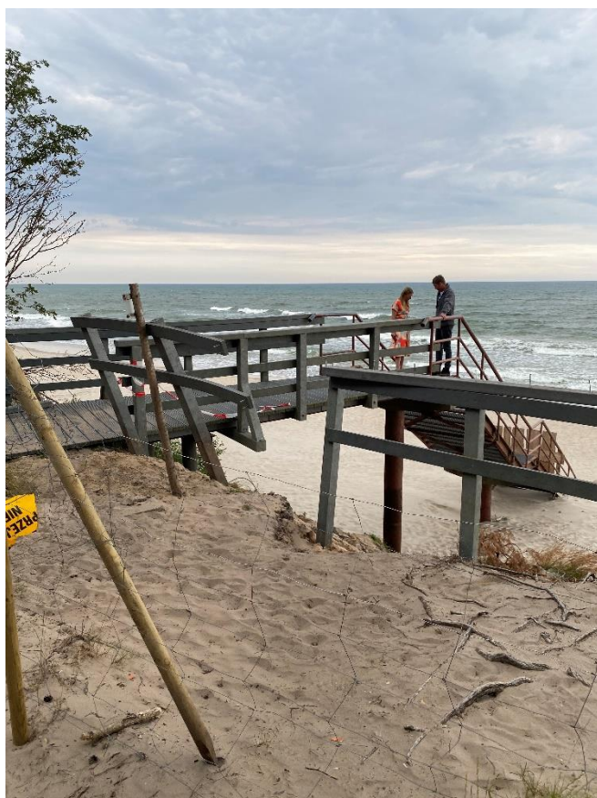
Ilustracja 1. Zdewastowane schody i uszkodzone barierki
