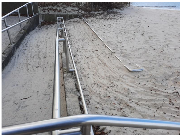
Ilustracja 2. Zasypany podjazd dla osób ze szczególnymi potrzebami
