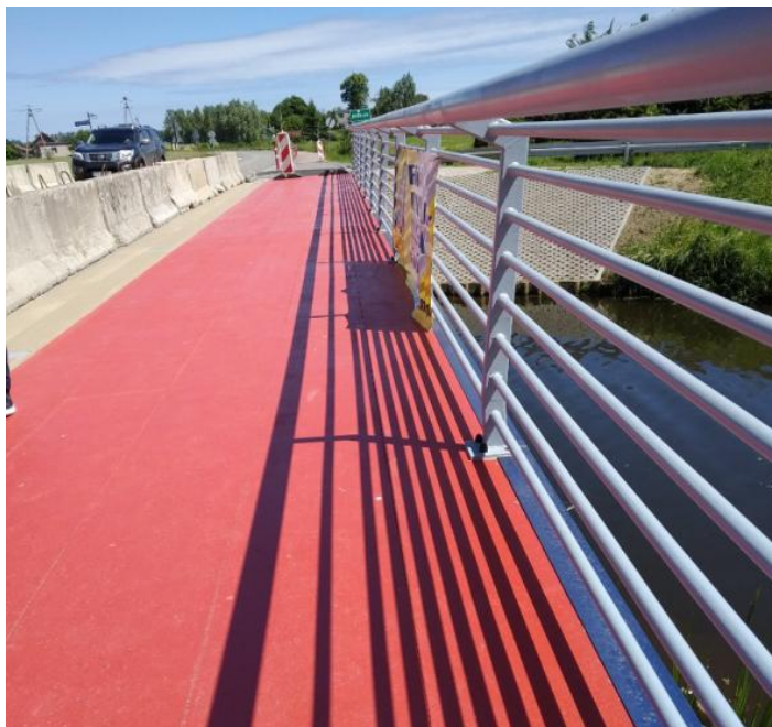
Fotografia 17. Odgicie balustrada na obiekcie inżynieryjnym, trasa R9, gmina Cedry Wielkie.
